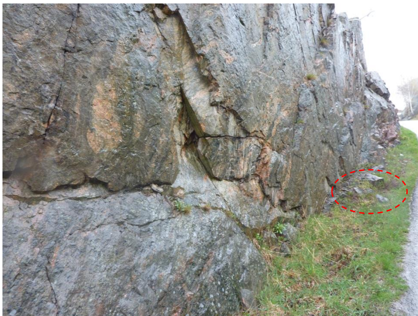
Foto 5. Brant bergskärning utmed norra sidan av vägen lokalt med överhäng.
