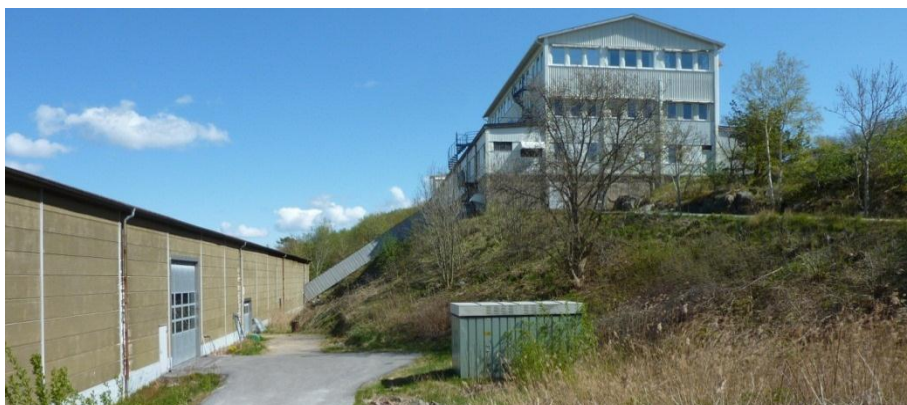
Foto 6. Något oregelbunden slänt med osäker uppbyggnad.
