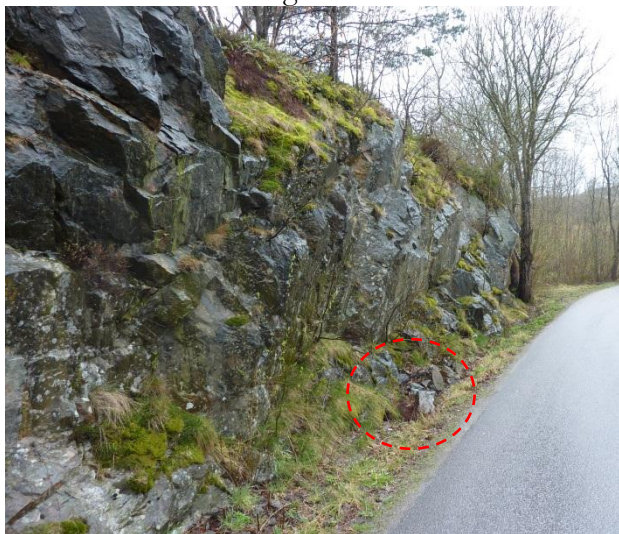
Foto 1. Bergskärning sydväst utmed vägen med blocknedfall
